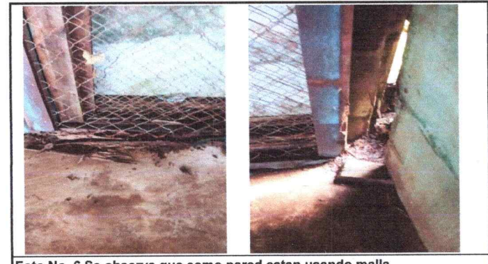
Foto No. 6 Se observa que como pared estan usando malla
