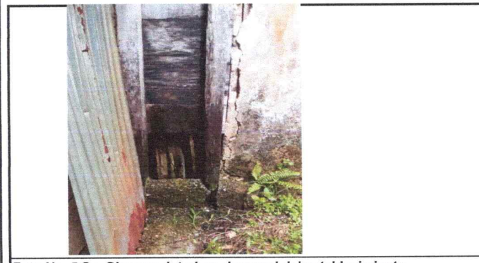
Foto No. 5 Se Observa deterioro de pared del establecimiento
